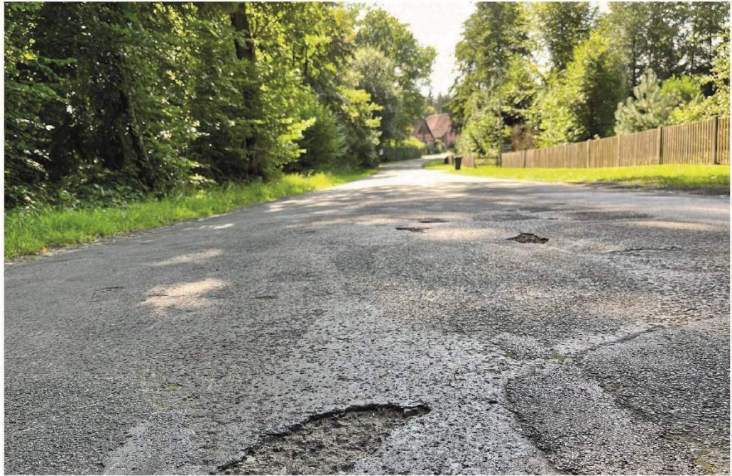
Ordentlich ramponiert: Die Ortsdurchfahrt in Tietlingen hat die besten Zeiten hinter sich. Wie und wann die Straße erneuert wird, ist noch offen. Foto: Reinbold
