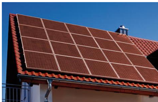
Farblich angepasste Aufdach-Anlage mit ruhigem Gesamterscheinungsbild ( www.abakus-solar.de )
